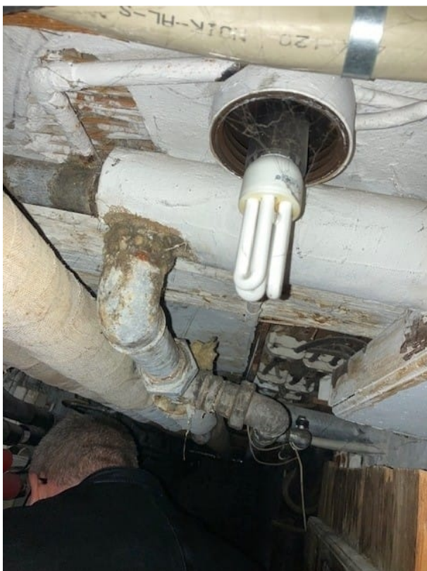
Eksempel på rørs tilstand i kældre.
