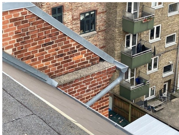
Beton afsats fremstår ru og afviser derfor ikke vand, sne mv. derfor kommer der følgeskader. Hul ved zink kan give vandindtrængen.
