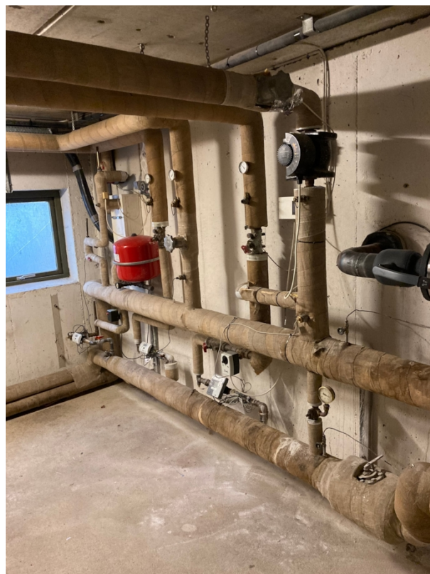
Traditionelt opbygget fordelerarrangement
