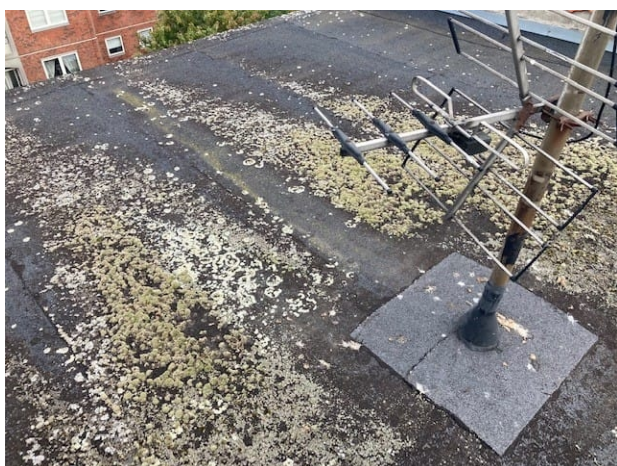
Mos/alge angreb i et lokalt område omkring antenne
