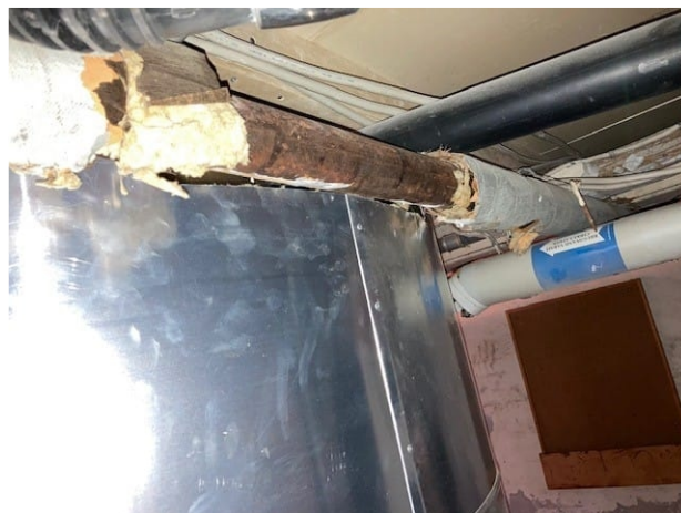
Eksempel på at rørisoleringen ikke bliver udbedret efter der er udført ad - hoc reparationer.
