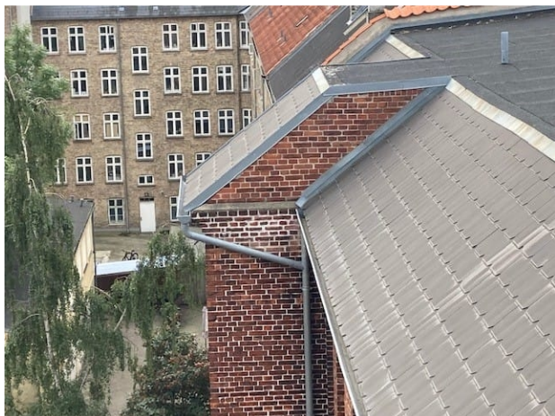
Bitrappelårn med opfugtet område bla. pga. der ingen drypkant er på betonafsatsen
