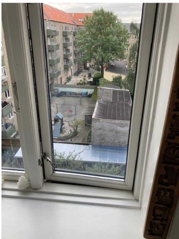
Eksempel på at gårdvinduet tilstand indvendigt ikke afspejler den udvendige stand
