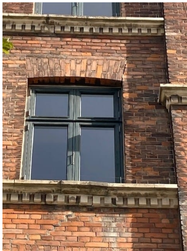
Eksempel på sætningskader både over og under vinduer
