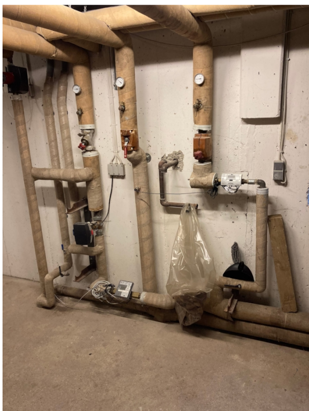
Eksempel på rør mv. der ikke er i brug og som der med fordel kunne "ryddes op i."
