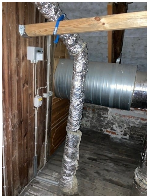
Ventilationsrum på loft med teknik
