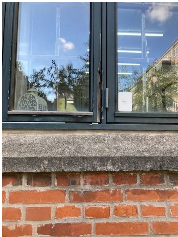
Eksempel på vindue i forfald
