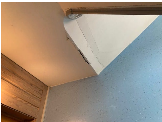
Eksempel på ødelagt puds i hovedtrappeopgangen
