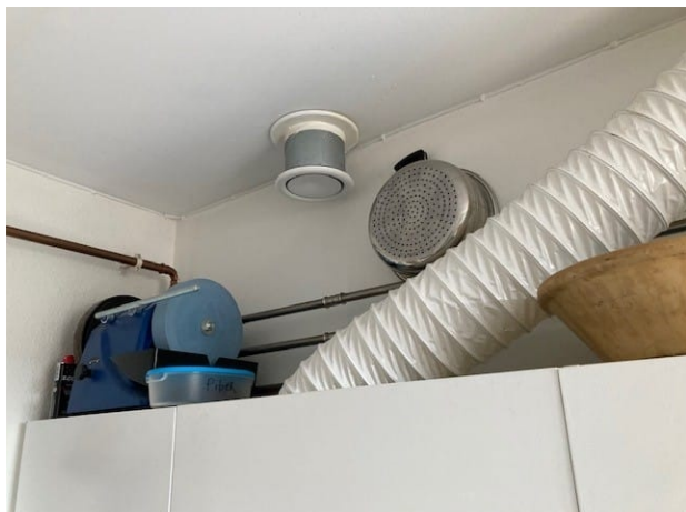
Eksempel på ventilation i køkken hvor nogle er ført direkte ud igennem gårdfacaden
