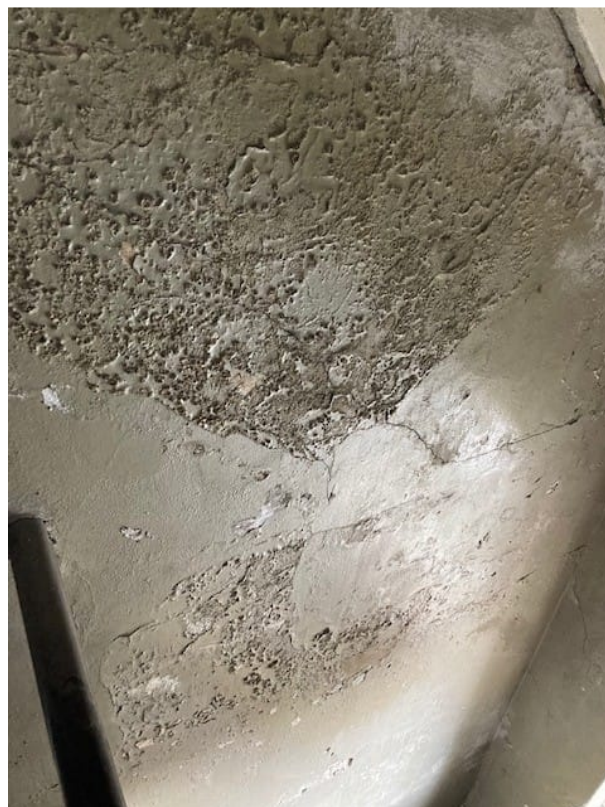
Bitrappevægge fremstår flere steder i utrolig dårlig stand
