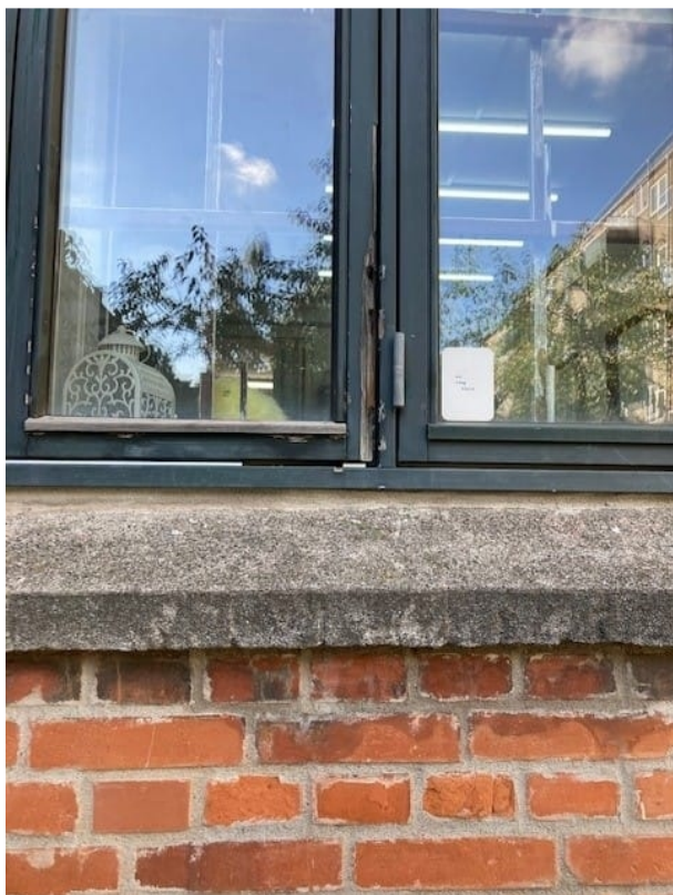
Karm ødelagt ( kan være i forbindelse med et forsøg på indbrud)
