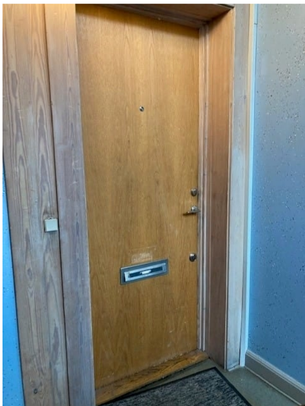
Lejlighedsdør med træ omkring som med fordel kan laves om
