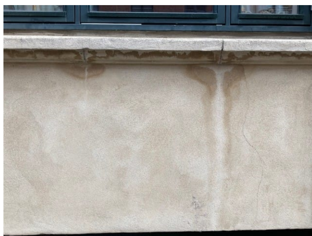
Eksempel på revner i sålbænke og brystningsmur som er med til at give følgeskader
