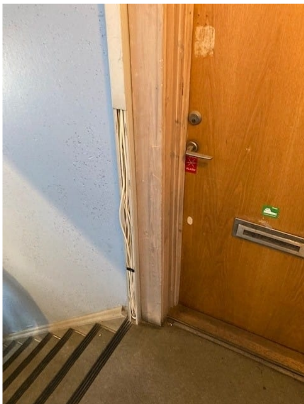
Manglende dæksler mv. i hovedtrappeopgangen
