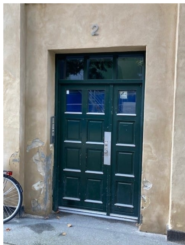
Ødelagt puds pga. grundfugt/saltpeter udtræk mv.
