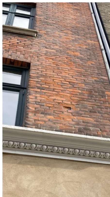
Område på gadefacaden hvor emaljen på murstene er ødelagt og er sårbar overfor vejrlig
