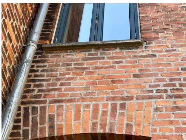
Revne i sålbænk, ødelagte mursten hvor emaljen smuldrer mv.
