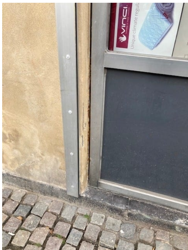
Sokler bør løbende/årligt gennemgås for skader, revner mm.
