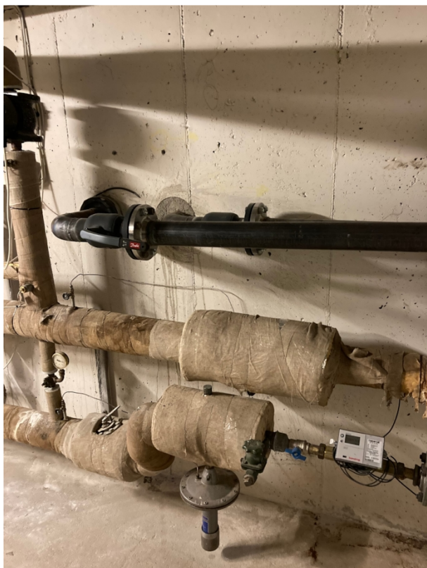
Nyere fjernvarmeforsyningsrør bør isoleres
