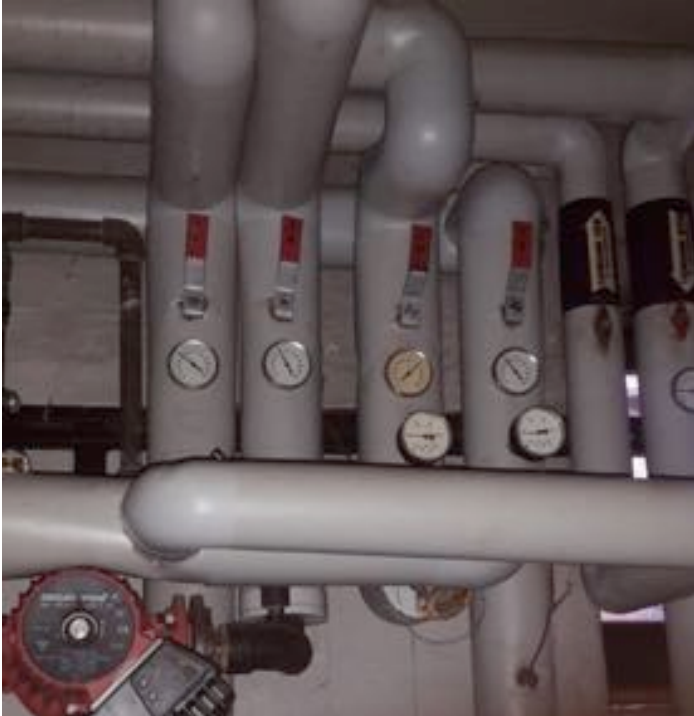
Vand/varme rør i fin stand
