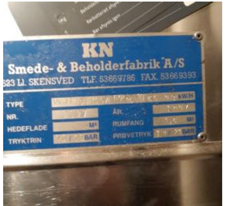
Informationsplade på varmtvandsbeholderen
