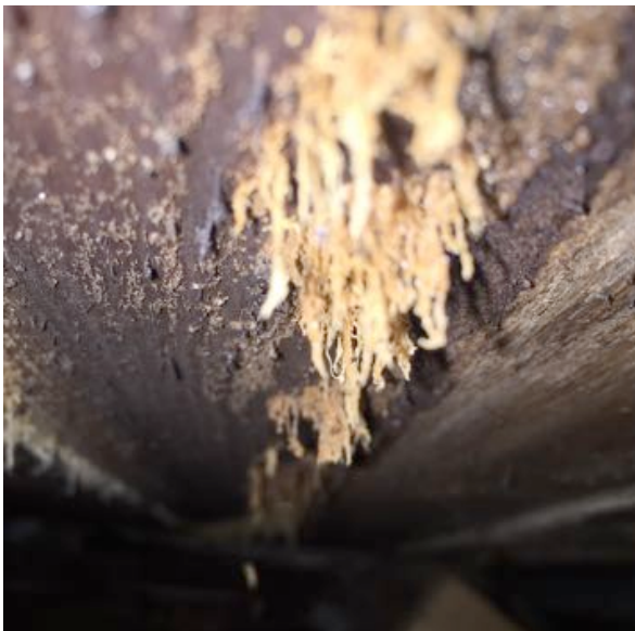
Udtræk i forskallingsbræt
